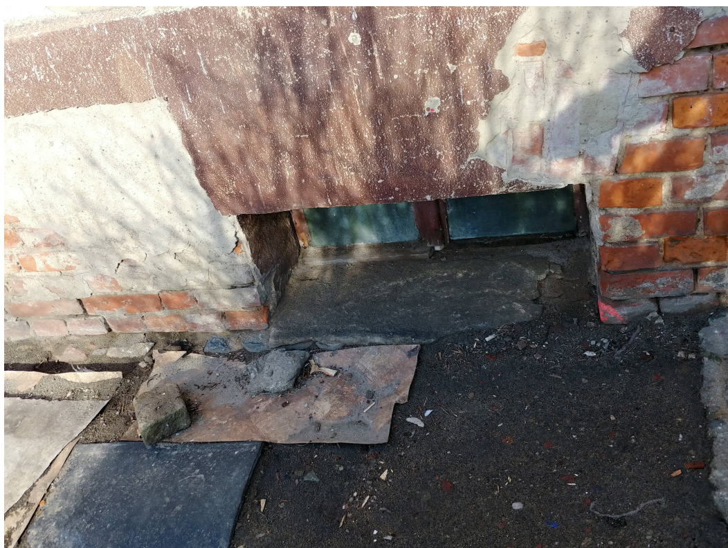
Gryfice, ul. Broniszewska 17 silne zawilgocenia ścian cokołu
